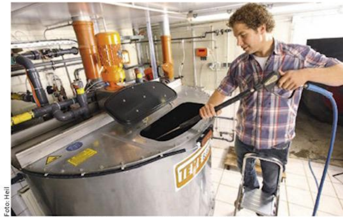
Beläge an der Mischbehälter-Innenwand sind regelmäßig zu beseitigen.
